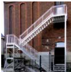
Noodtrap buiten Echelle de secours extérieure
