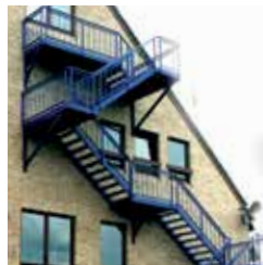
Noodtrap buiten Echelle de secours extérieure
